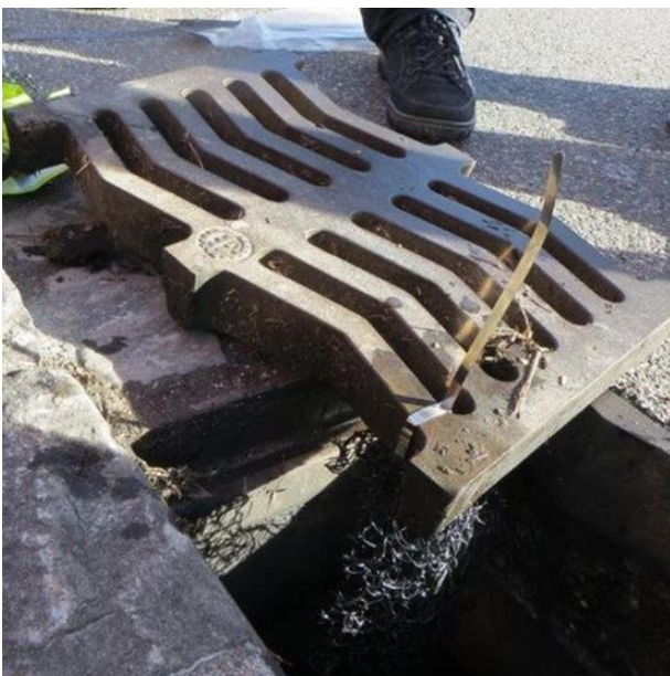
Metallkabelbinder ist angezogen.
