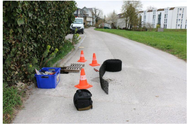
Die Umgebung des Schachts sichern!
