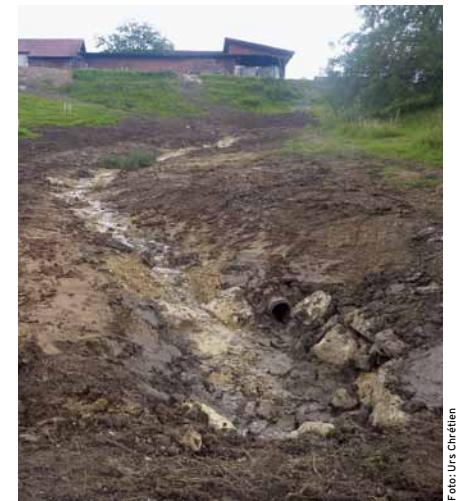
Im November 2014 wurde der frisch ausgedolte Oberlauf des Cholmattbächlis in Titterten eingeweicht.
