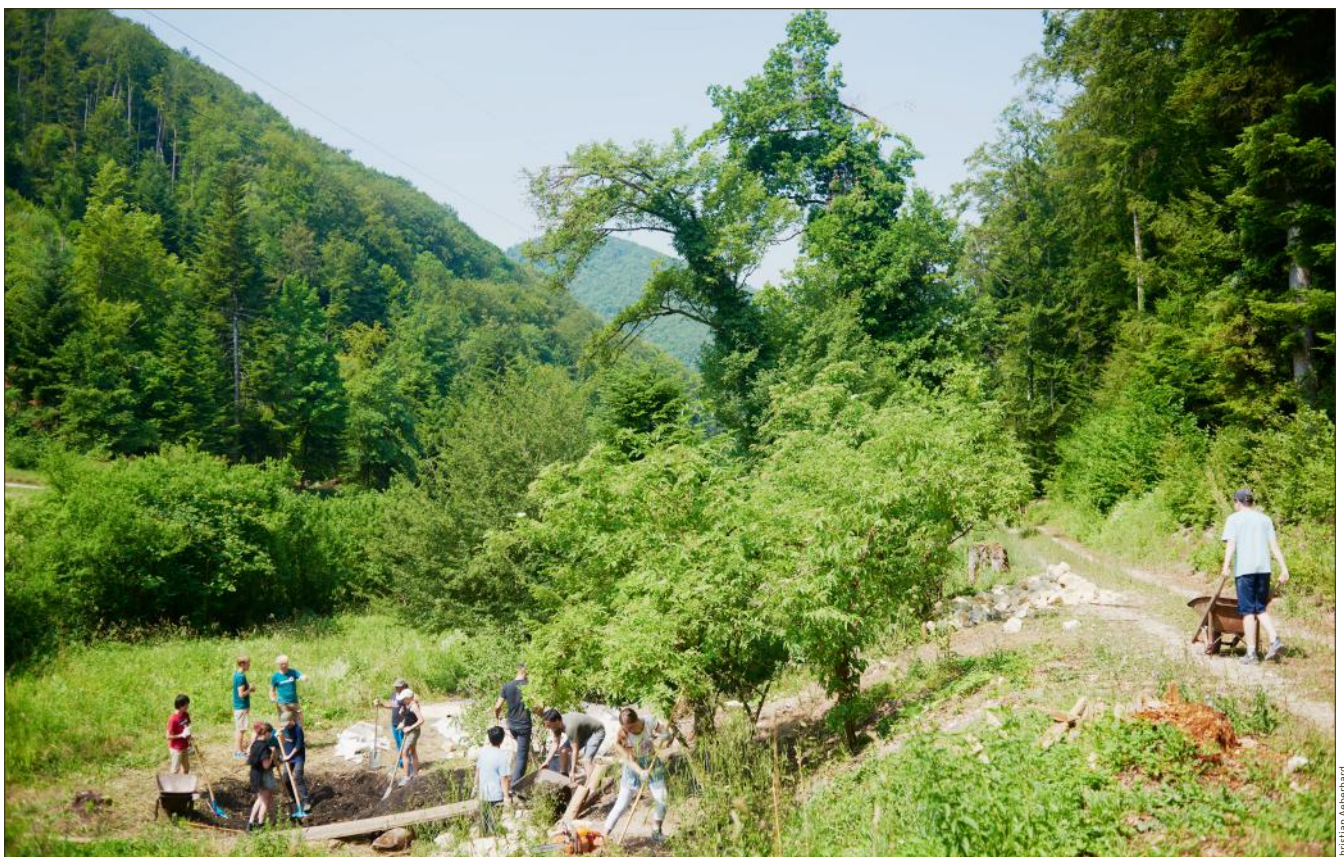
Schülerinnen und Schüler einer Sekundarschulklassen bauen unter einer Stromtrasse während mehreren Tagen unter Anleitung von Mitarbeitenden von Pro Natura Baselland in Handarbeit einen Weiher und Kleinstrukturen für Amphibien, Reptilien und weitere Kleinlebewesen.
