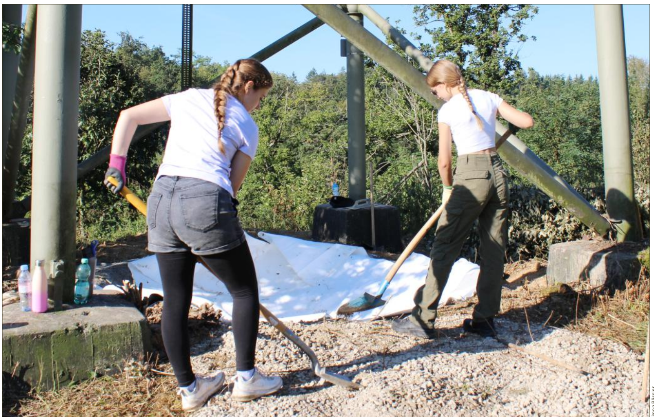
Vierorts werden die Amphibientümpel direkt unter den Strommasten angelegt, da diese Flächen auch im offenen Kulturland nicht landwirtschaftlich genutzt werden. Das Ausheben der Grube erfolgt per Hand mit Pickel und Schaufel.
